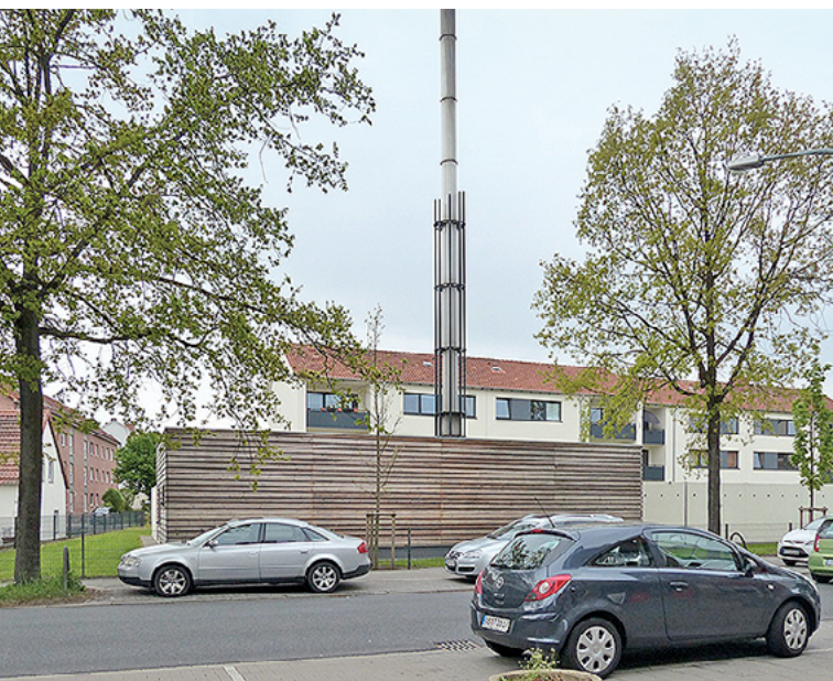
Umsetzung: dezentrale Energieerzeugung durch ein Blockheizkraftwerk
